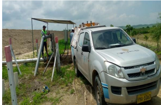
Fotografía 3 Abastecimiento de combustible a la Patera (Estación de Bombeo de la Planta Colonche)
